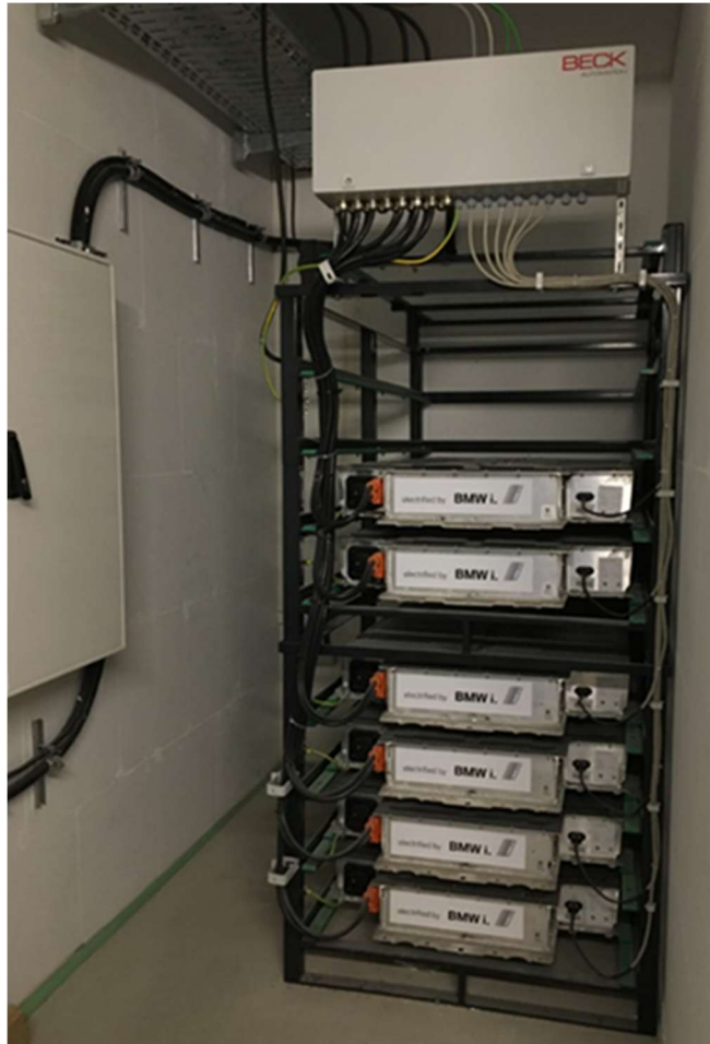
Die sechs Lithium-Ionen-Batterien sind im Keller des Kindergartens installiert.
